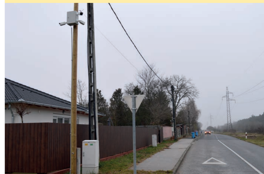
Folytattuk a térfelügyelő kamerák telepítését, így a Monostori-Debreceni út, a Diófa-Debreceni út és a Teleki-Oláh Sándor út sarkára kerültek térfelügyelő kamerák.
